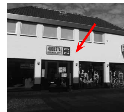
Reclame heeft vormgevingskwaliteit en de plaatsing is afgestemd op de gevelindeling van het pand.
